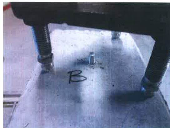
Leggera screpolatura cls
